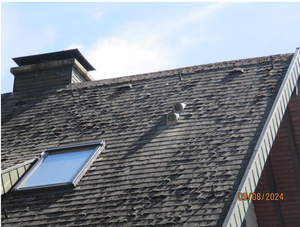
Foto 2: Lüftungziegel mit durch Gitter verschlossener Öffnung.
